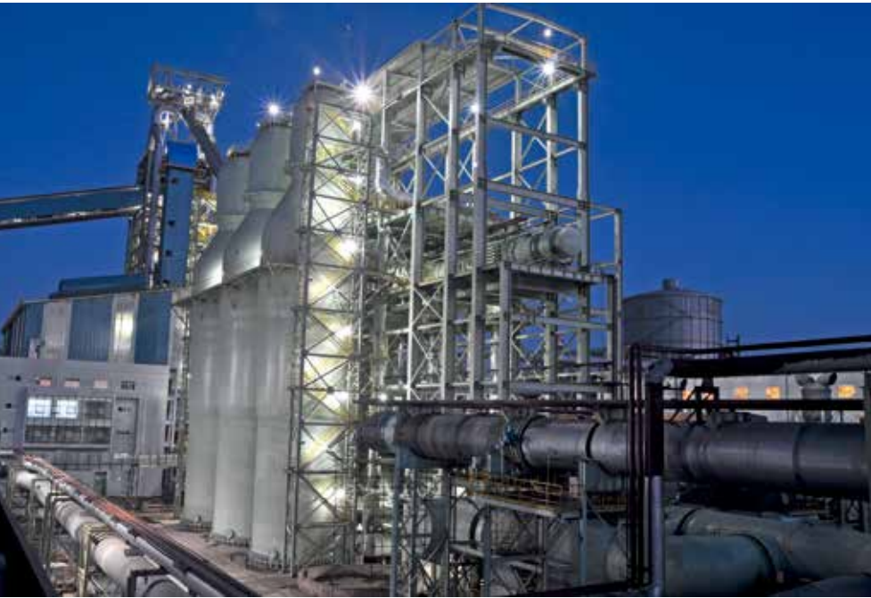
昆钢6号高炉热风炉
