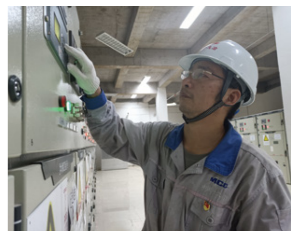
党员刘建川调试设备
