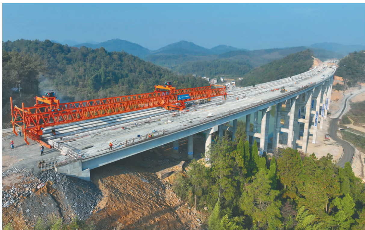
11月14日,随着最后一块T梁的成功架设,重庆公司承建的G59高速项目新新段烟竹寺2号大桥实现双幅贯通。(陈晓宇 摄)
