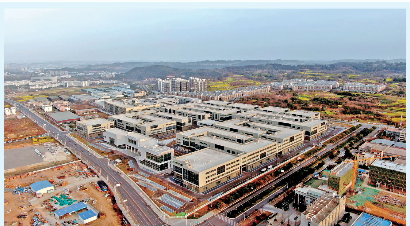
中国十九冶承建的绵阳高新智能制造产业园二期项目 (陈星宇 摄)
